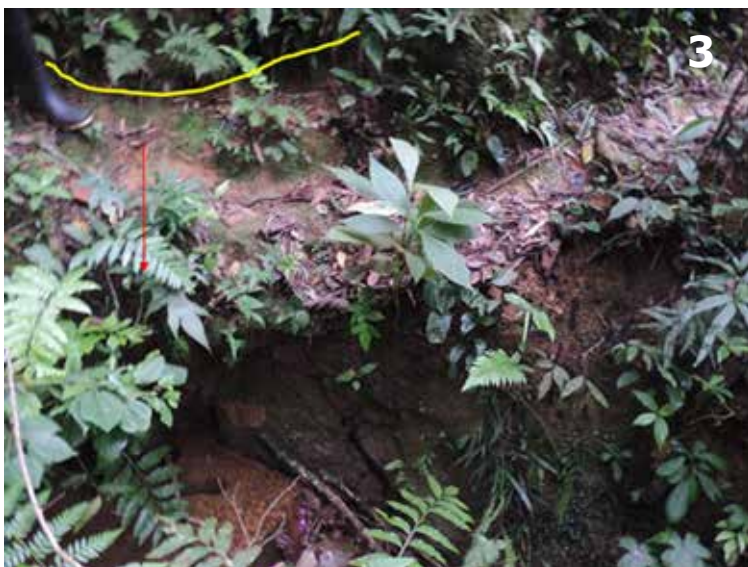
Figura 3. Trecho de trilha da Água Branca. Em amarelo, indicando trilha com 40 cm de largura e em vermelho mostrando solapamento basal, causado pela erosão.
